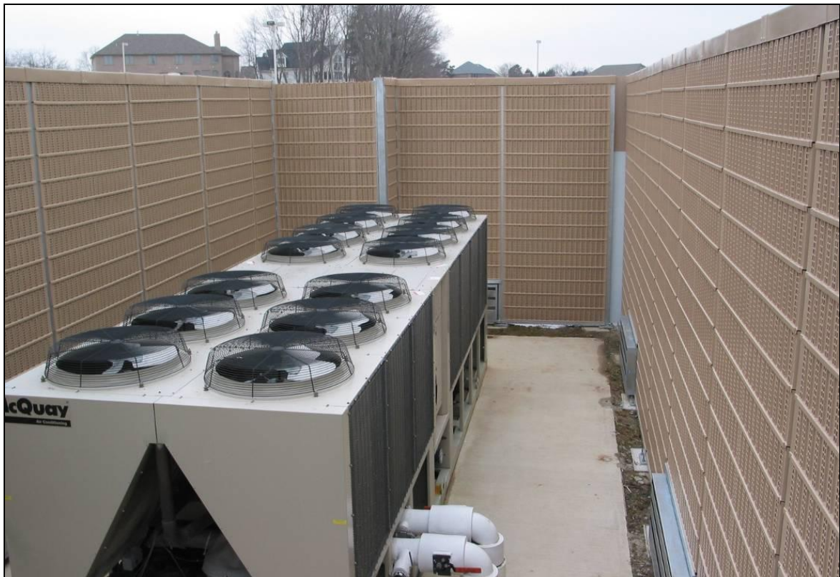
Εικόνα 9-7: Συστήματα VRV εντός ηχομονωτικής περίφραξης σε οροφή κτηρίου
