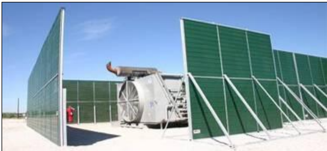
Εικόνα 9-1: Χρήση ηχοπετασμάτων σε σταθερές πηγές θορύβου
