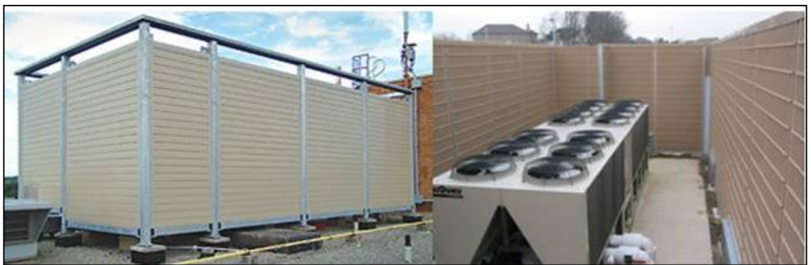
Εικόνα 9-8: Συστήματα VRV εντός ηχομονωτικής περίφραξης σε οροφή κτιρίου
