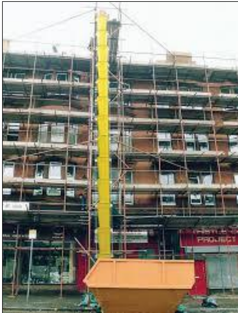
Εικόνα 9-6: Σωλήνας μεταφοράς σκουπιδιών (waste chute)
