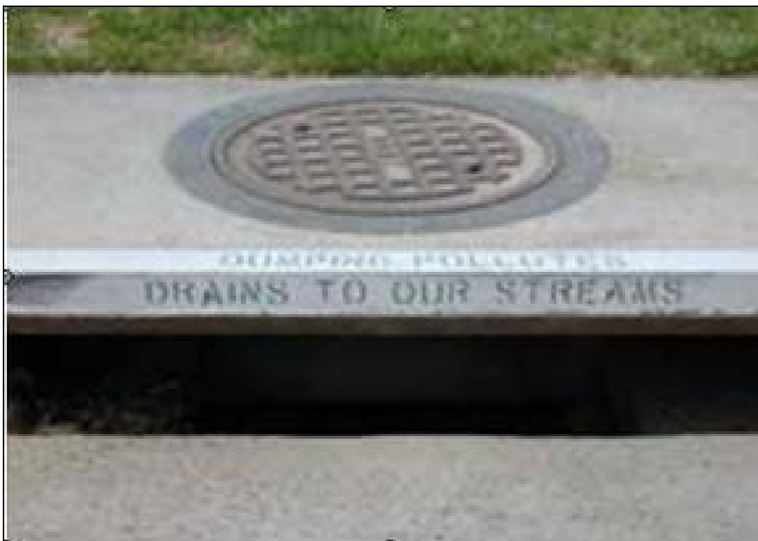
Εικόνα 9-9: Σηματοδότηση συστήματος συλλογής όμβριων υδάτων
