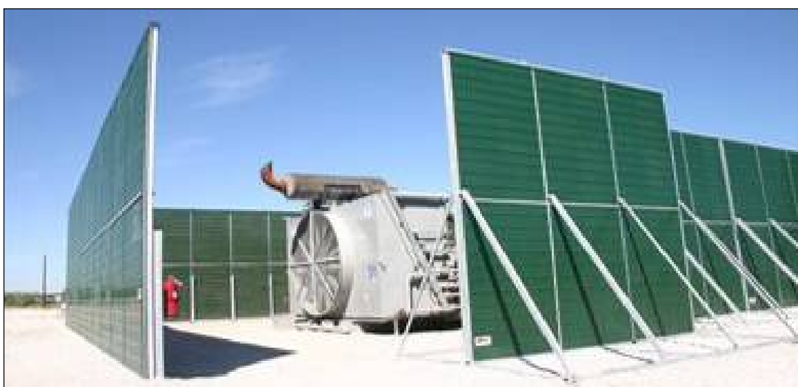
Εικόνα 9-1: Χρήση ηχοπετασμάτων σε σταθερές πηγές θορύβου
