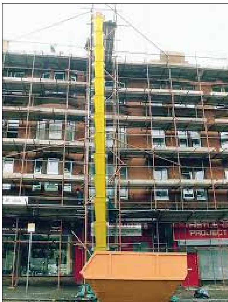
Εικόνα 9-7: Σωλήνας μεταφοράς σκουπιδιών (waste chute)
