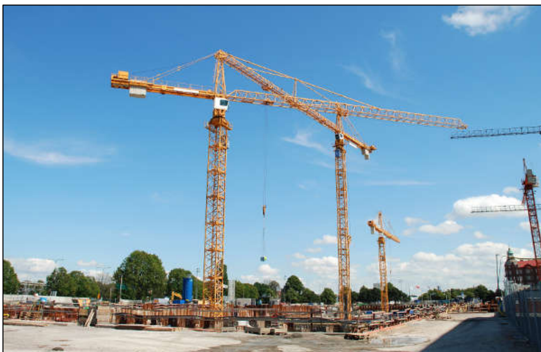
Εικόνα 6-8: Γερανός σταθερής βάσης
