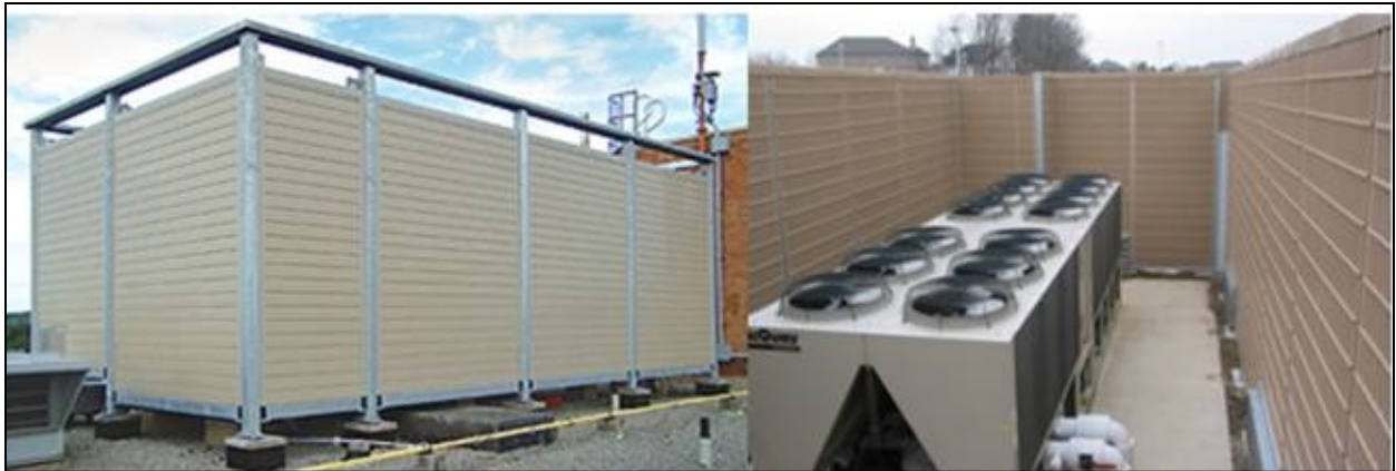
Εικόνα 9-8: Συστήματα VRV εντός ηχομονωτικής περίφραξης σε οροφή κτηρίου
