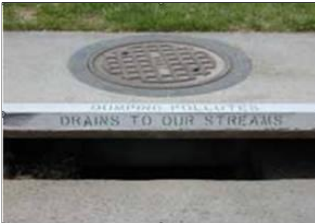
Εικόνα 9-15: Σηματοδότηση συστήματος συλλογής όμβριων υδάτων
