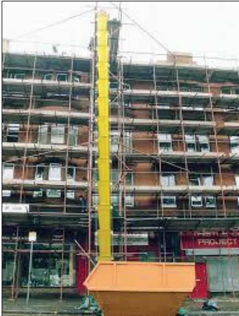
Εικόνα 9-8: Σωλήνας μεταφοράς σκουπιδιών (waste chute)
