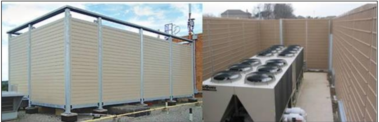
Εικόνα 9-13: Συστήματα VRV εντός ηχομονωτικής περίφραξης σε οροφή κτηρίου
