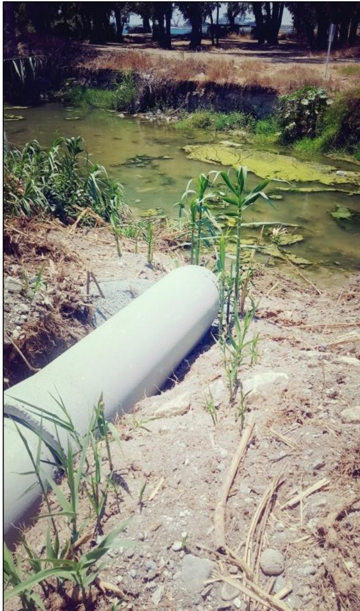
Φωτογραφία 9-1: Υφιστάμενος αγωγός ομβρίων υδάτων που καταλήγει στον παραπόταμο του Γαρύλλη
