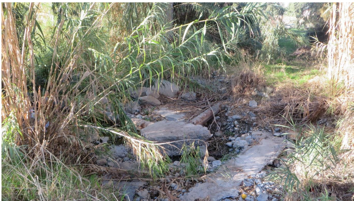
Φωτογραφία 7.26: Κοίτη υδατορέματος με υποδομές Συμβούλιου Υδατοπρομήθειας Λεμεσού σε απόσταση περίπου 160 μέτρα ανατολικά του χώρου ανάπτυξης
